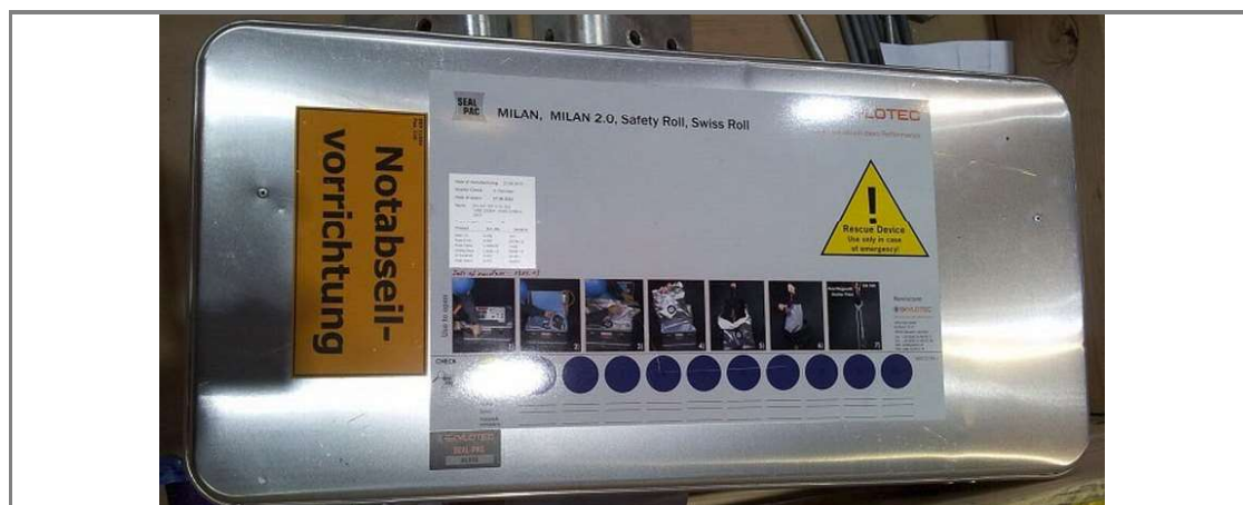
Abb. 3: Notabseil-ausrüstung in der WEA
