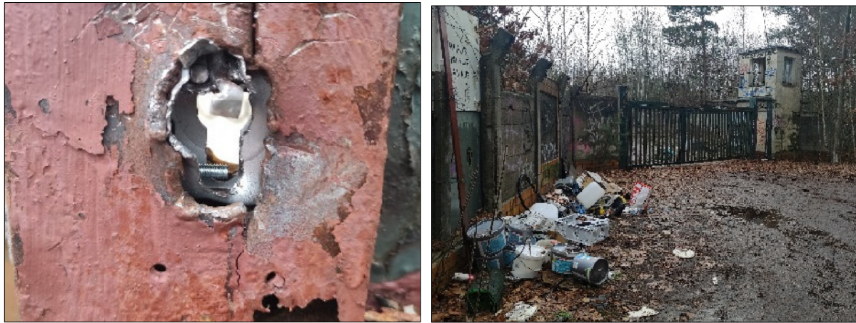
Abbildungen 1 und 2: zerstörtes Schloss der Toranlage am östlichen Eingang und illegal entsorgter Abfall (Aufnahme: LA Panse, 13.01.2022)
