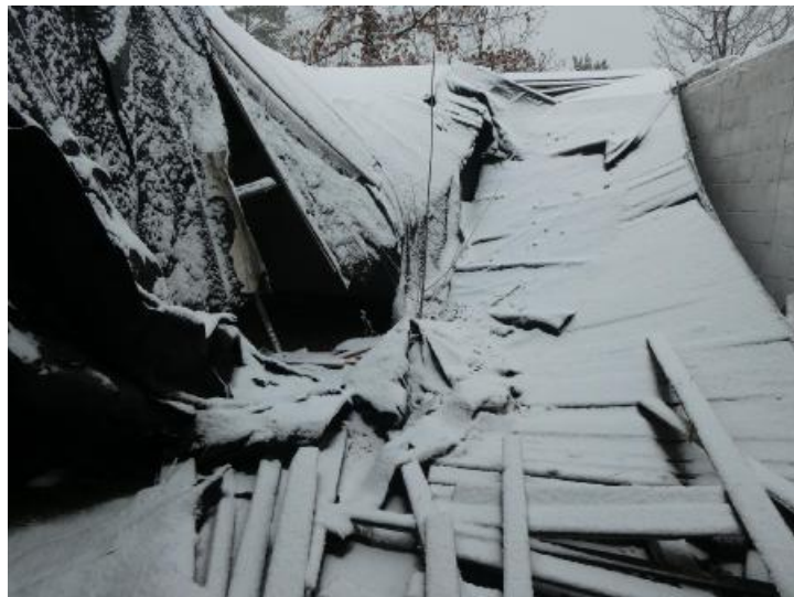
Gebäude 5 - Lagergebäude, linker Raum mit eingestürztem Dach
