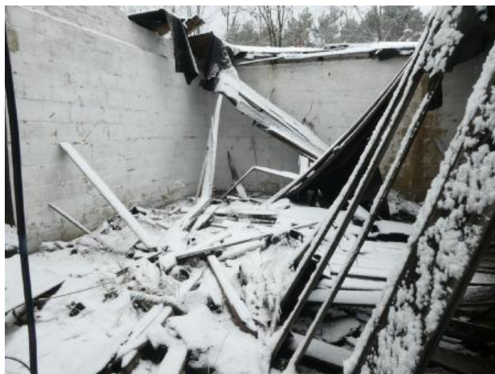
Gebäude 1 - Lagergebäude, mittiger und linker Raum mit eingestürztem Dach
