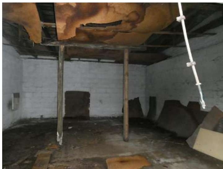
Gebäude 5 - Lagergebäude, mittlerer Raum mit einsturzgefährdetem Dach, keine organoleptischen Auffälligkeiten
