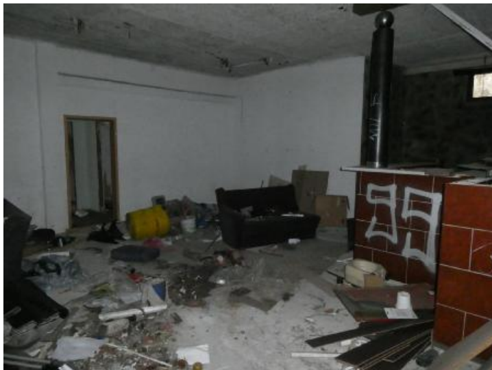
Gebäude 9 - Vandalismus und Abfälle, keine organoleptischen Auffälligkeiten
