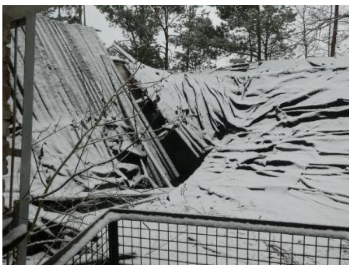
Gebäude 12 - eingestürztes Dach
