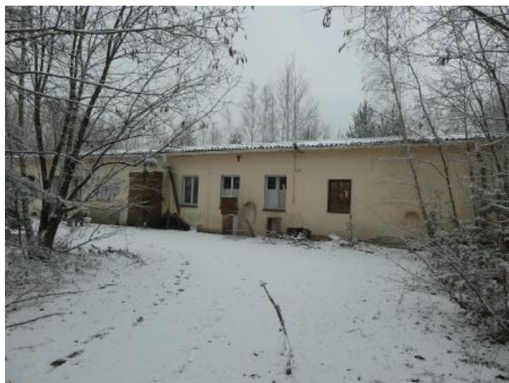
Gebäude 9 - Lagerhalle, zuletzt Tanzclub, mehrere Räume, stark verwüstet durch Vandalismus und illegale Ablagerung von Abfällen
