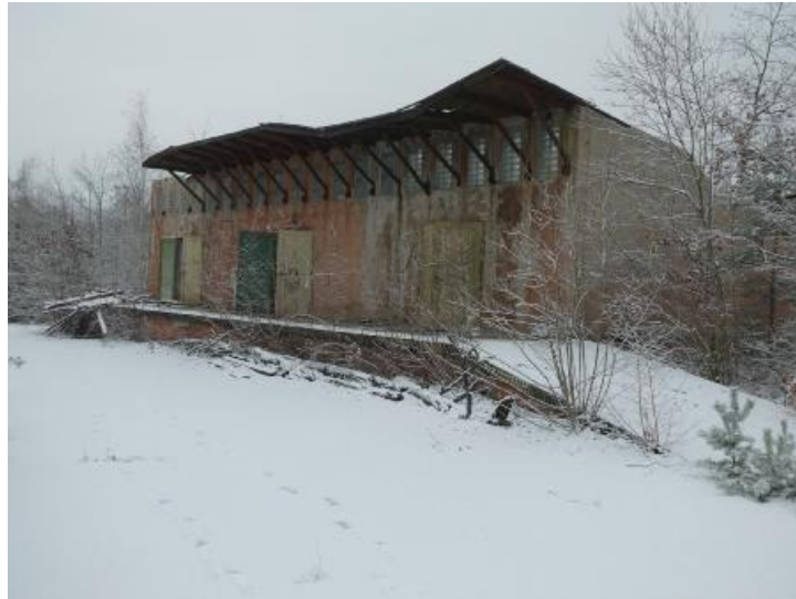
Gebäude 5 - Lagergebäude mit eingestürztem bzw. einsturzgefährdetem Dach
