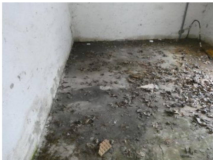
Gebäude 6 - Kleines Lagergebäude mit lokalen Schwarzfärbungen des Fußbodens
