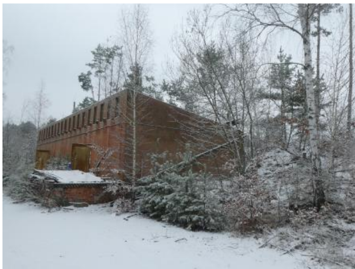
Gebäude 12 - Lagergebäude mit vollständig eingestürztem Dach, 2 Räume
