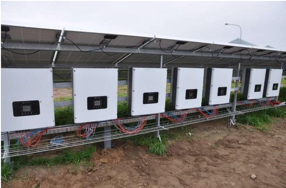
Abb. 1 Wechselrichter unterhalb der Modulreihen angebracht
