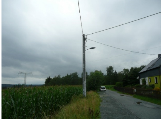
Blick in Richtung Westen auf die 110 kV-Leitung
