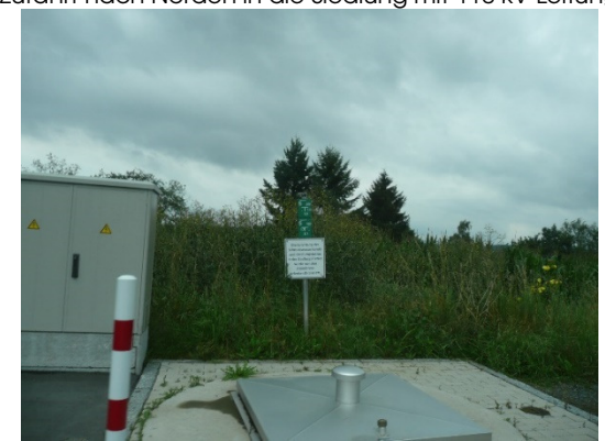
Schmutzwasserkanal der Siedlung Platten
